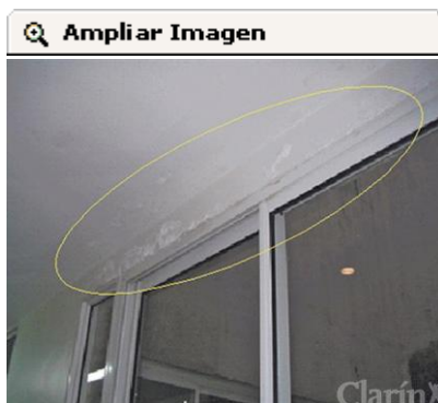
Filtración. Los goterones evitan que el agua ingrese por tensión superficial entre el dintel y el muro.
