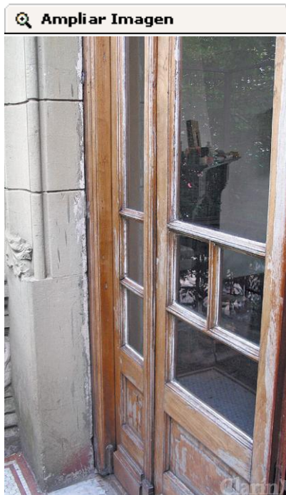
Antigua. Carpintería de madera afectada por humedad perimetral.
