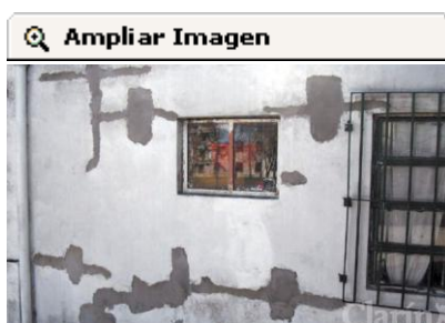
Fisuras. Originadas por tensiones de borde por defectos en la ejecución de antepechos y dinteles.
