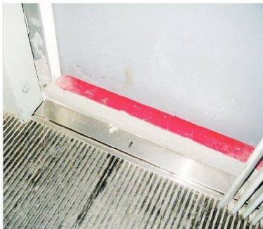
Problema habitual. Falla del límite de fin de carrera.
