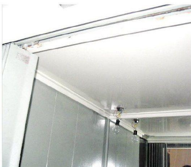
Cabina. Falta mantenimiento en la instalación de iluminación.
