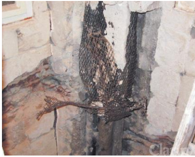
Colapso por par galvánico. Una cañería de hierro galvanizado corroe el metal desplegado que la envuelve.
