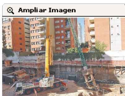
GRUA CONTRA GRUA. AYER POR LA TARDE, EN EL MOMENTO EN EL QUE RETIRABAN LA MAQUINA QUE SE HABIA CAIDO.
