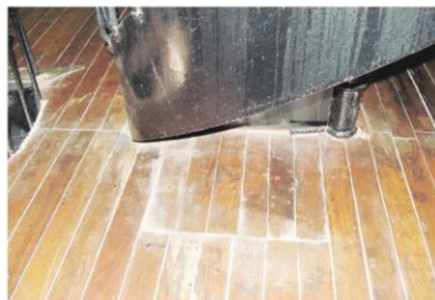
PhotoA. Piso de madera atacado por humedad ascendente.
