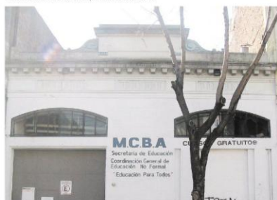
PhotoB. Se ejecutaron frisos para ocultar las fisuras originadas por dilatación de contracción.
